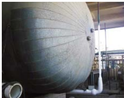
图 1 结霜管安装位置
