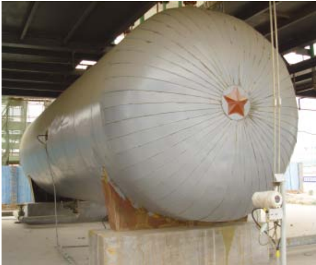
图 2 外测液位计现场安装图
